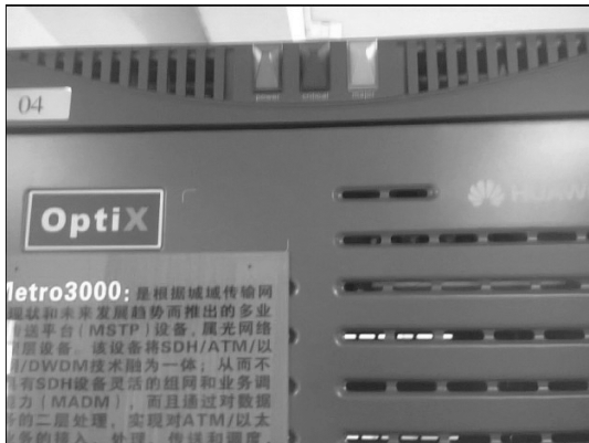
图 5.49 Opti×Metro 3000 设备发生主要告警时，机柜指示灯显示
