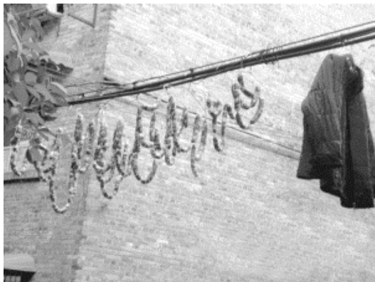
图 2.15 线路隐患实例
