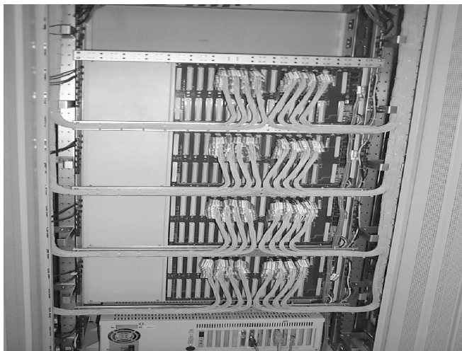
图 3.23 中继电缆在走线架上布放
