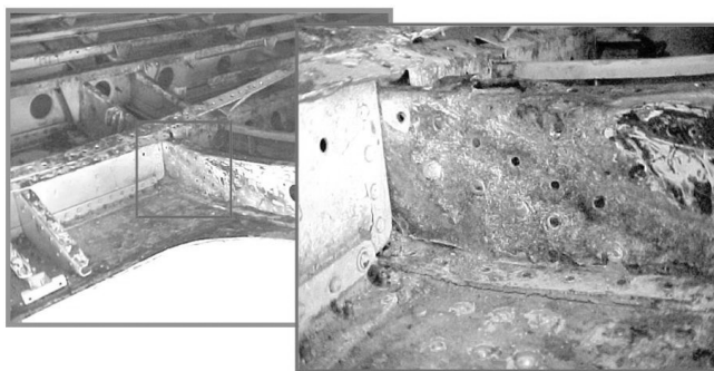
图 8.86 桁条、隔框及蒙皮内侧的腐蚀
