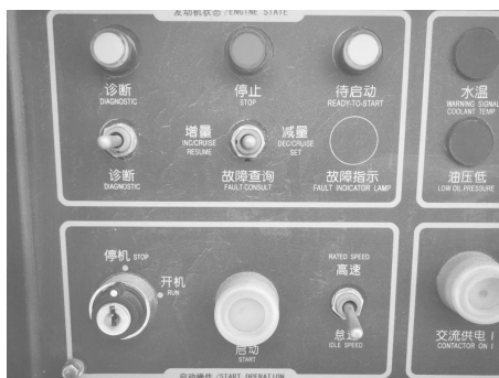
图 3.4 电源车控制面板供电、断电电门及各指示灯（一）
