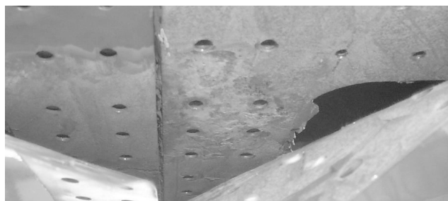
图 8.89 盖板缝隙处的腐蚀
